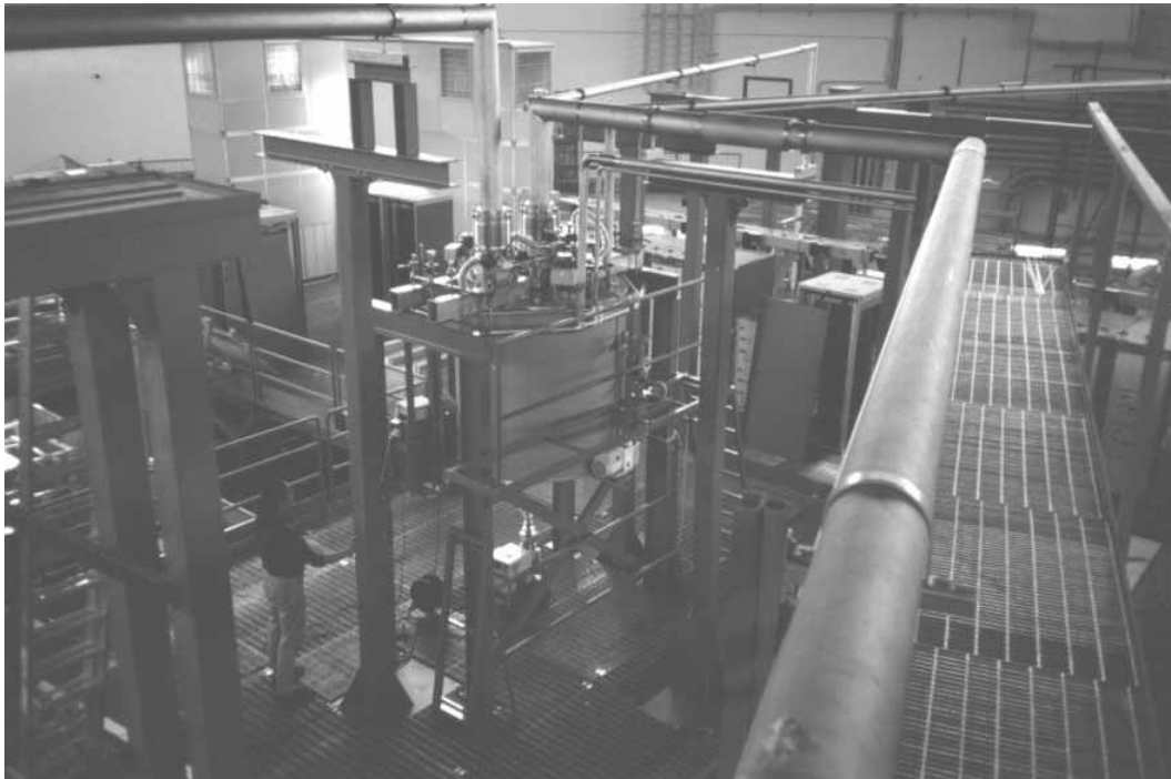
Figura 4 : Vista della Valve Box di distribuzione, del sistema di Linee di Trasferimento Criogeniche e dei loro supporti (Bridge) installate nella Sala DA NE
